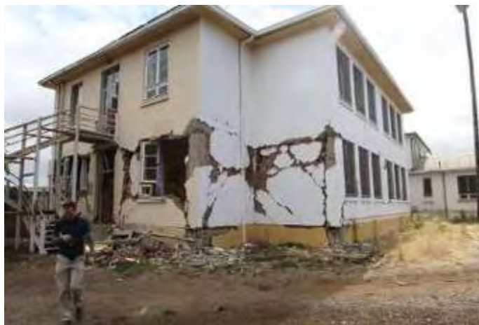
Edifici afectat pel sisme de Xile de l'any 2010. Font: US Geological Survey – USGS ( http://www.usgs.gov )
